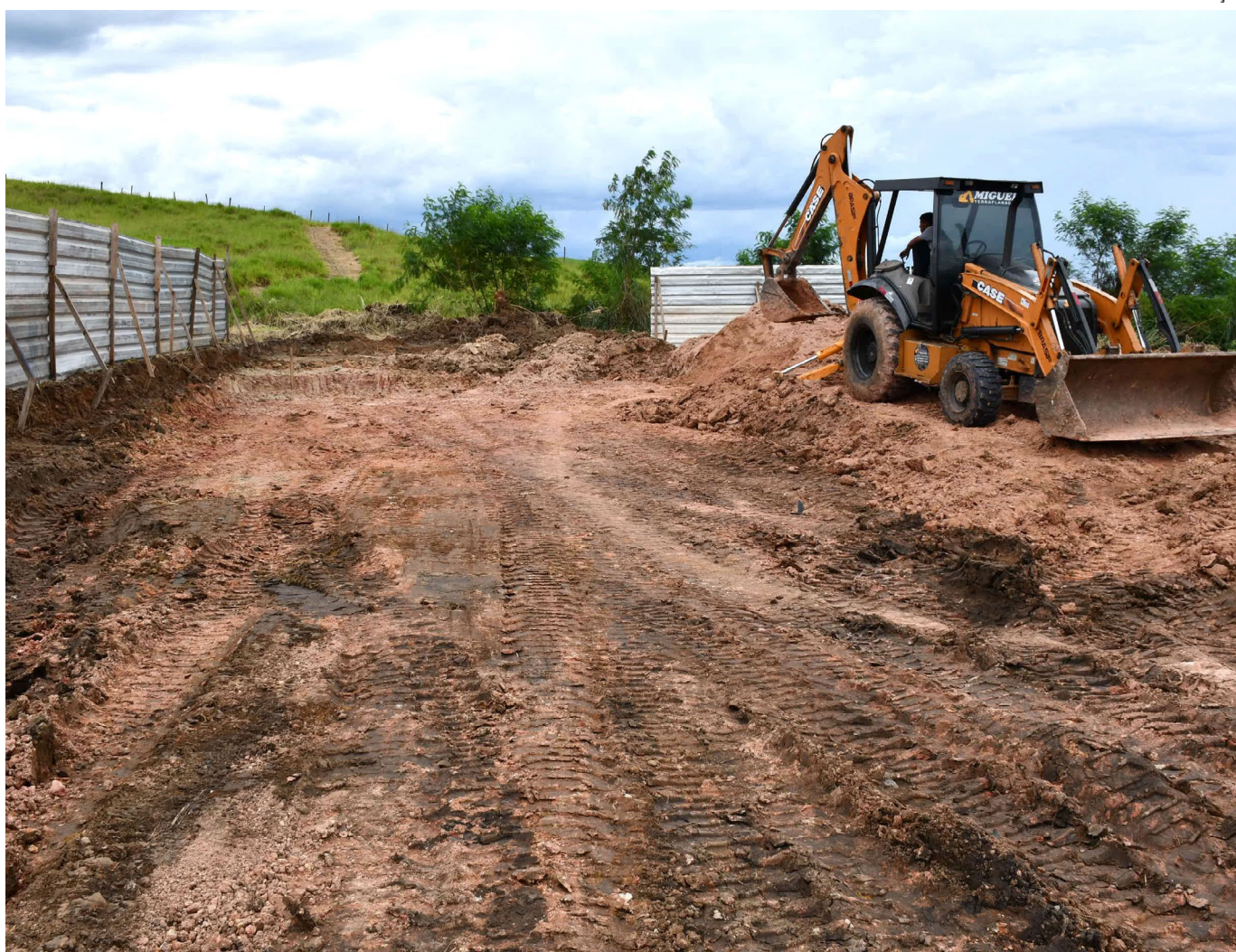
Cronograma de obras inclui pintura epóxi, alambrados, iluminação de LED e rampa para acessibilidade
