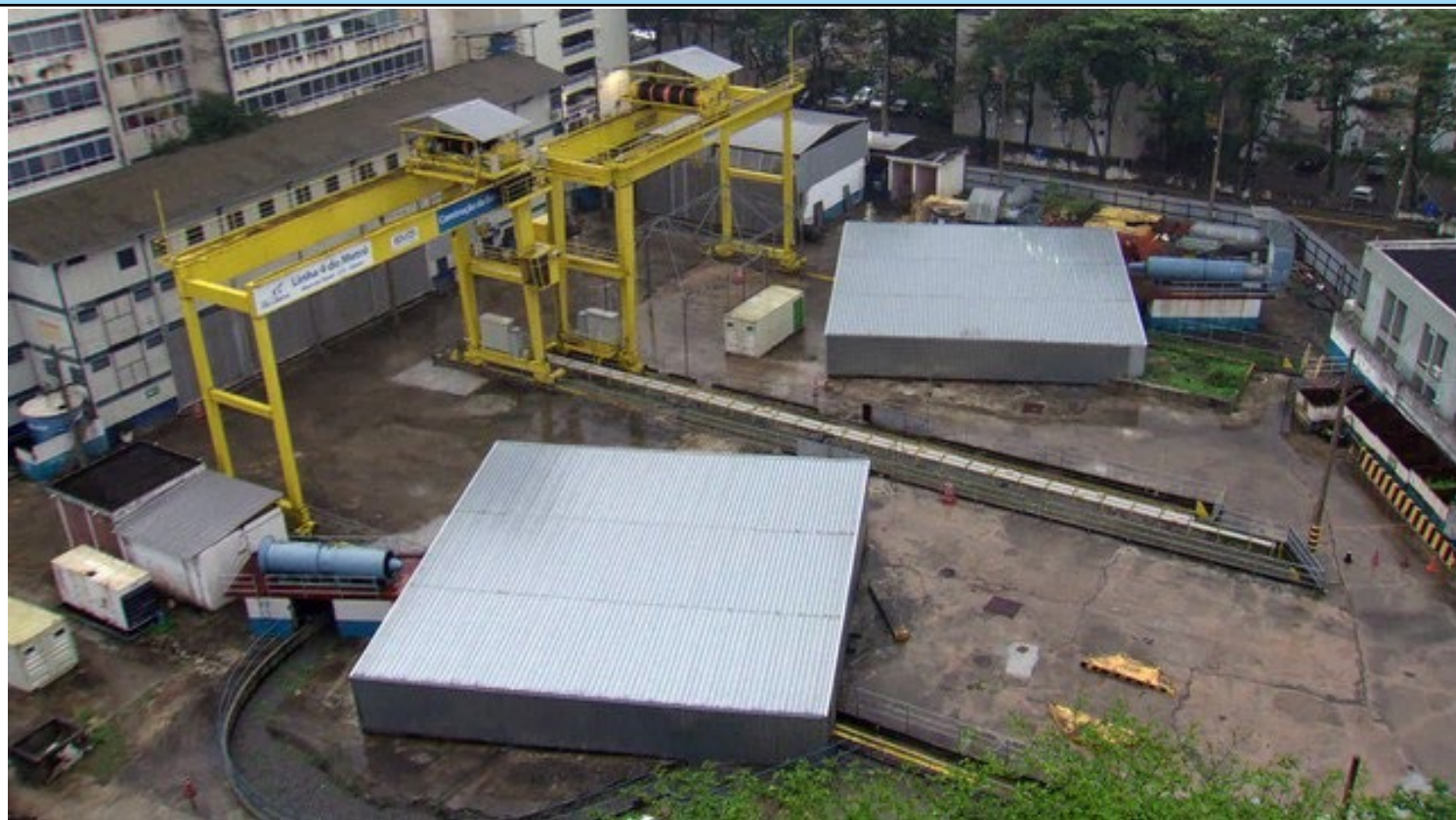
Metrô Rio arcaria com o valor das obras, em troca de extensão da concessão, e serviço seria executado pela Rio-Barra. Termos vão para o MPRJ e o TCE para formalização
