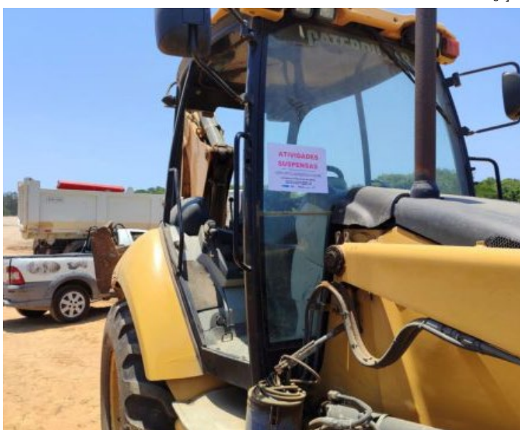
Os agentes e os técnicos flagraram desmatamento em uma área de quase oito campos de futebol, que daria lugar ao empreendimento
