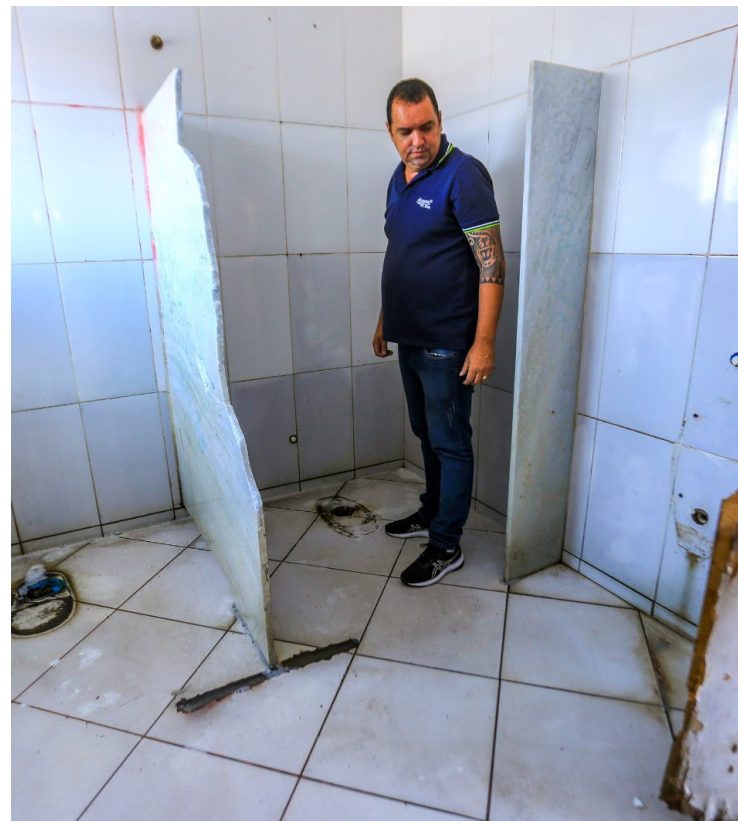
Paulo Sérgio Luna vistoriou os banheiros e verificou os prejuízos causados pelo vandalismo
