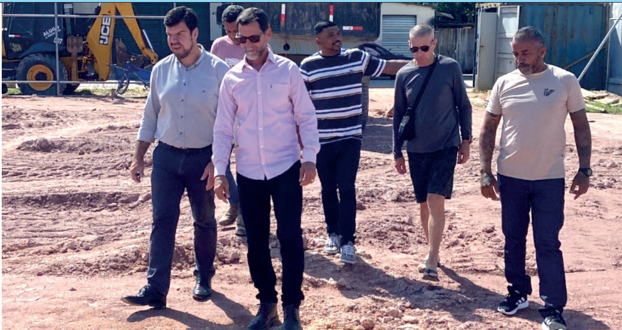
Obras em Andamento Refletem Compromisso com a Infraestrutura e o Bem-Estar da População
