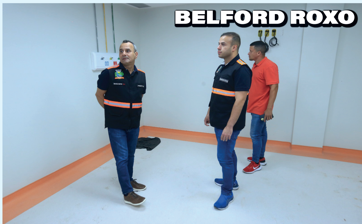
Waguinho, Matheus Carneiro e Vitor do Gelo fiscalizaram as obras da nova unidade de saúde em fase final
