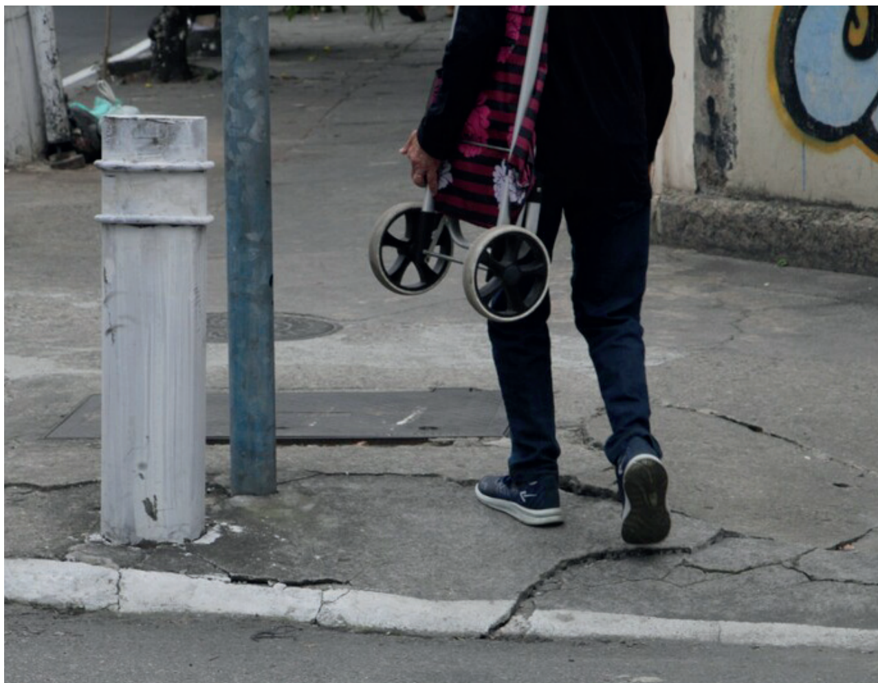
Buracos e desníveis causam quedas na Rua Visconde de Sepetiba, a cerca de 200 metros da sede da Prefeitura de Niterói
