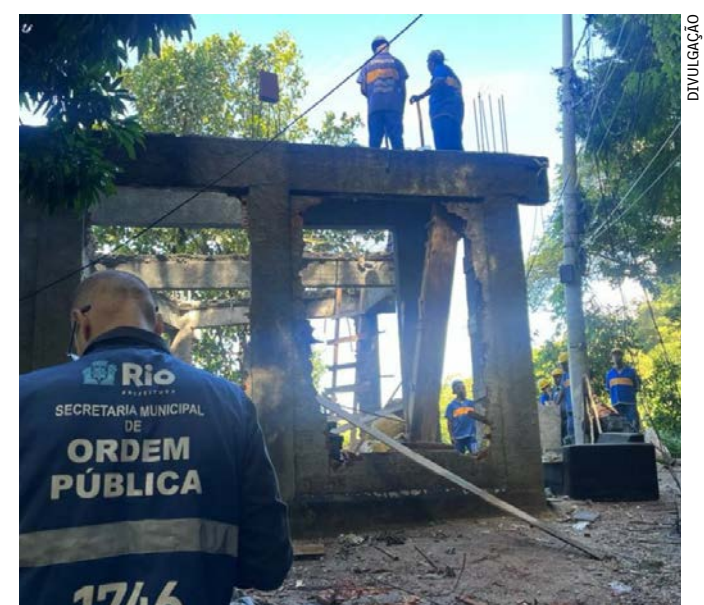
Ação acontece em estruturas erguidas pelo tráfico e sem um engenheiro responsável
