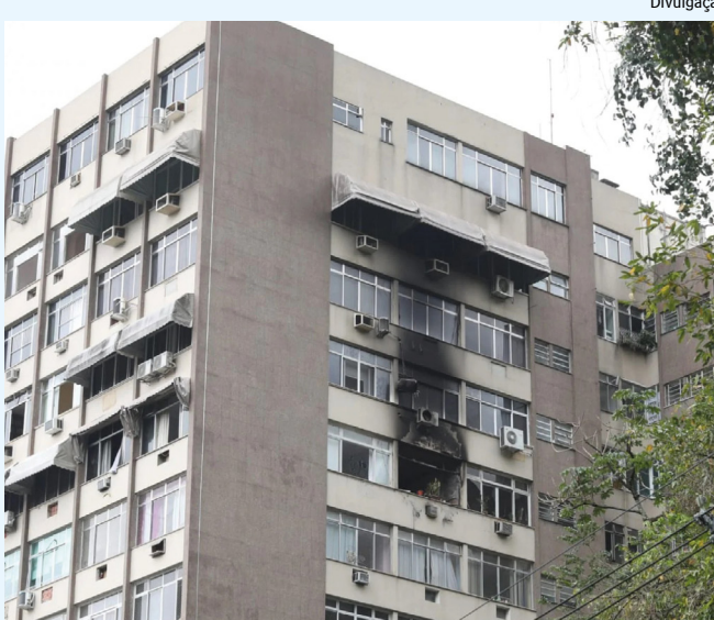
O incêndio começou no escritório do apartamento e depois seguiu para os outros cômodos
