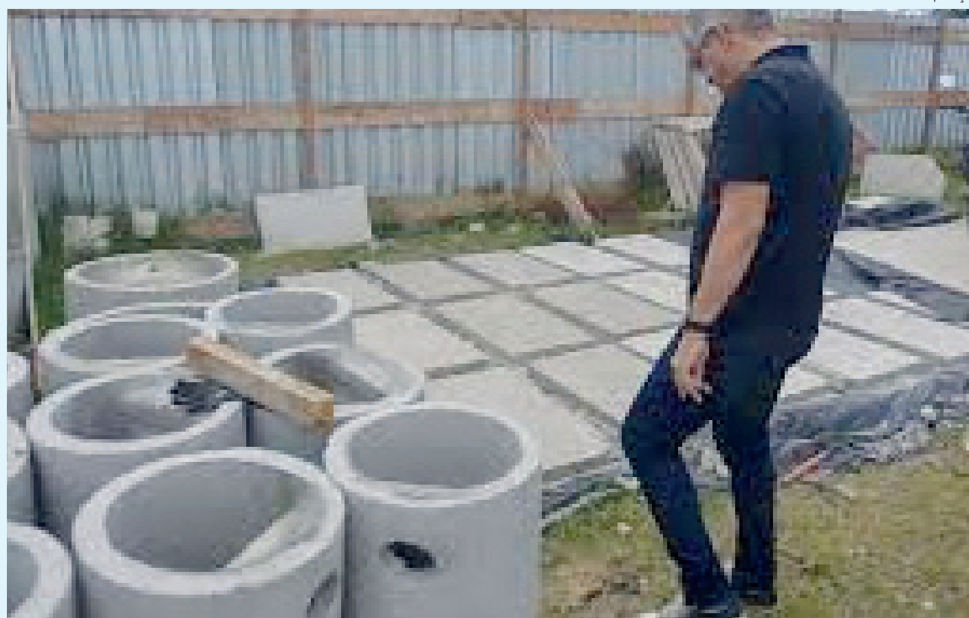
Além dos aparelhos já instalados, outros 30 filtros estão em processo de instalação, somando um total de 170 biodigestores instalados na localidade
