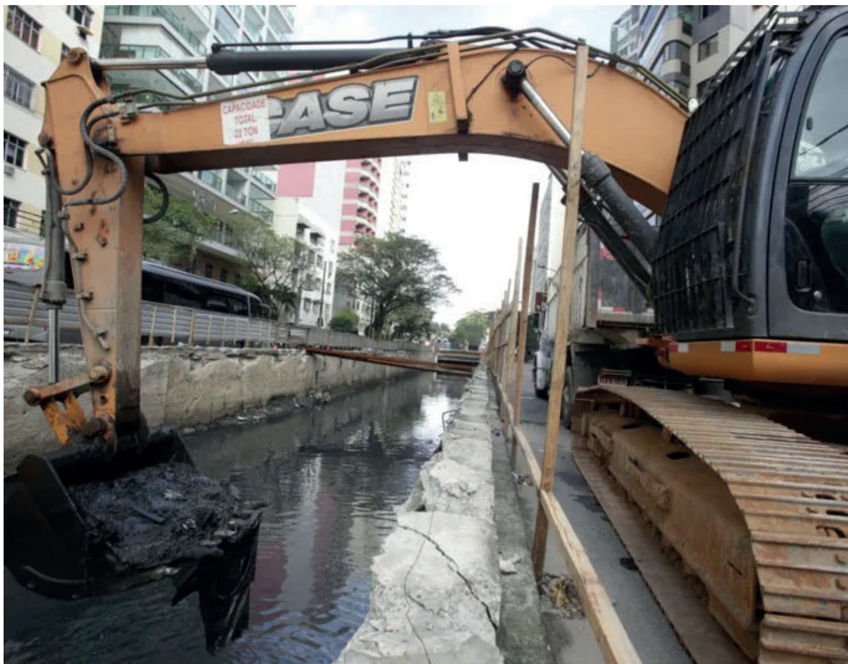
Após as obras estruturais, o local ganhará uma nova praça com dois mil metros quadrados
