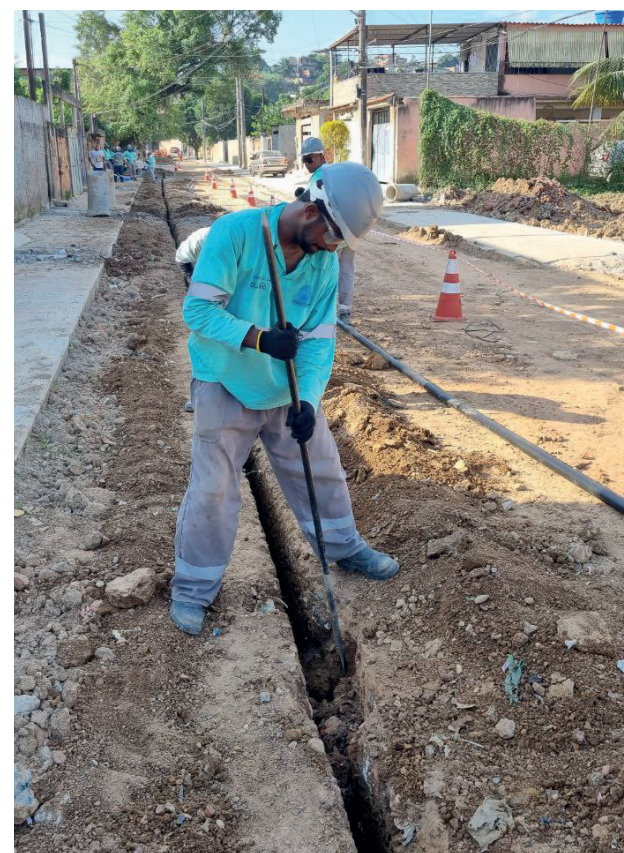
Em ação no bairro, a Águas do Rio iniciou o assentamento de 8 km de tubulação
