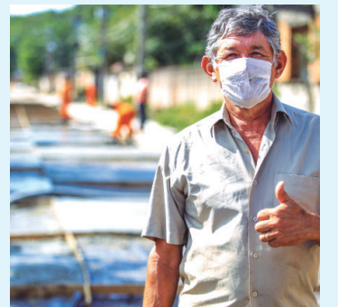
Morador da Rua Alfa, no Babi, Raimundo Lopes destacou que a concretagem acabou com a lama
