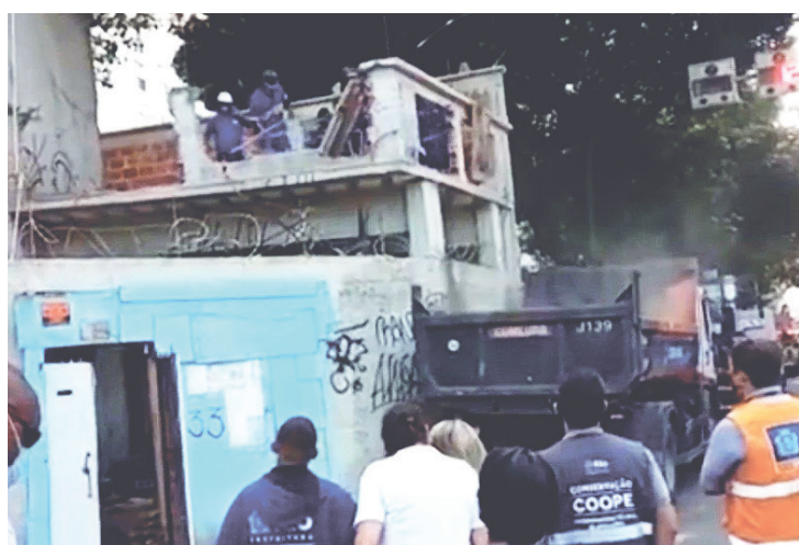
Construção não possui documentação
