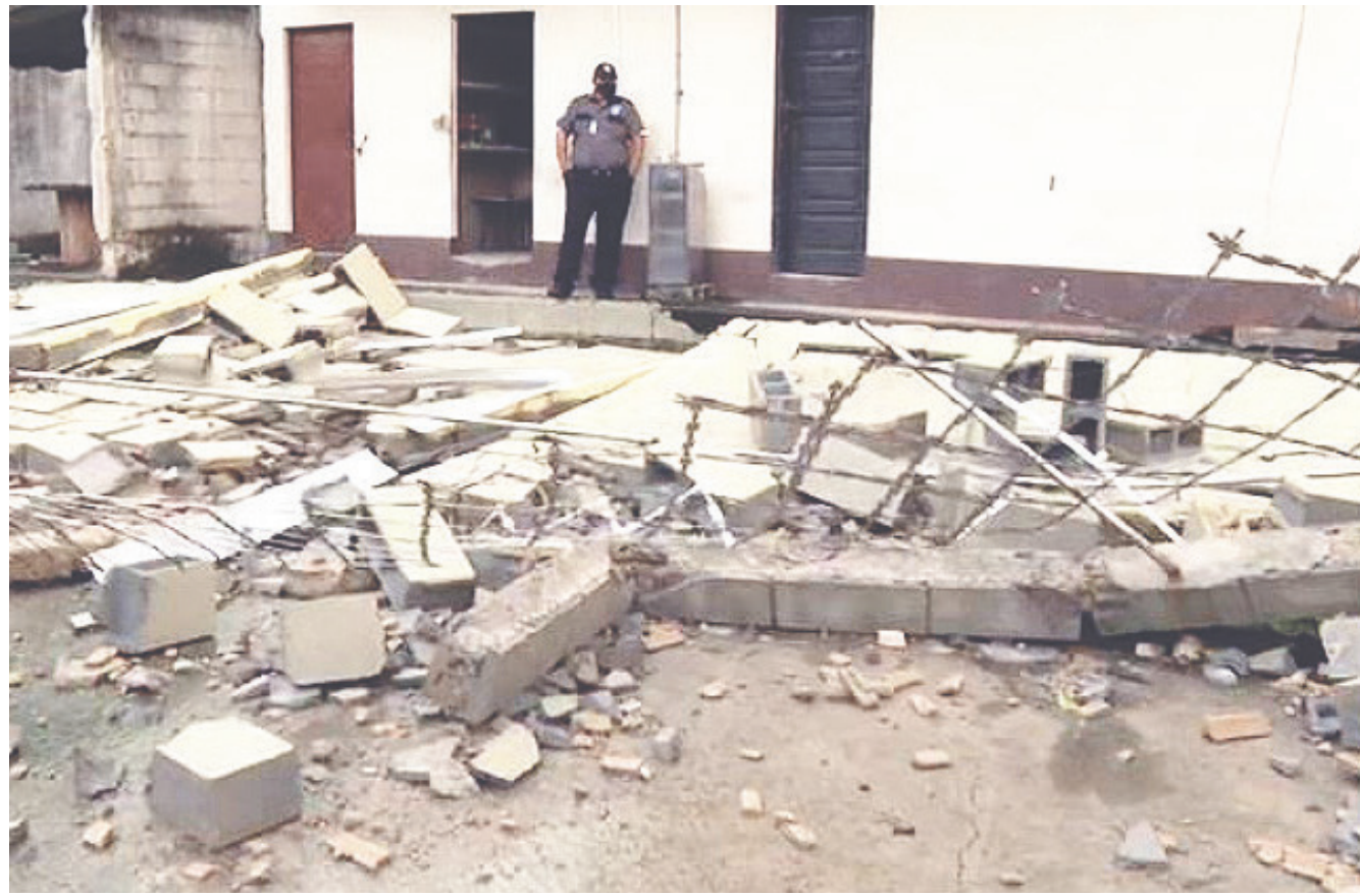
O muro de uma operadora de telefonia foi arrancado pelo vento
