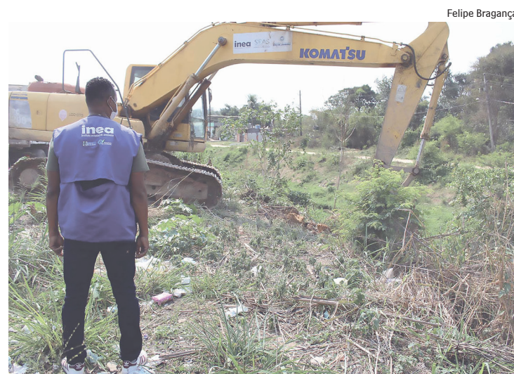
O próximo local a receber os maquinários serão os rios Delamare e, em seguida, o Tambaú
